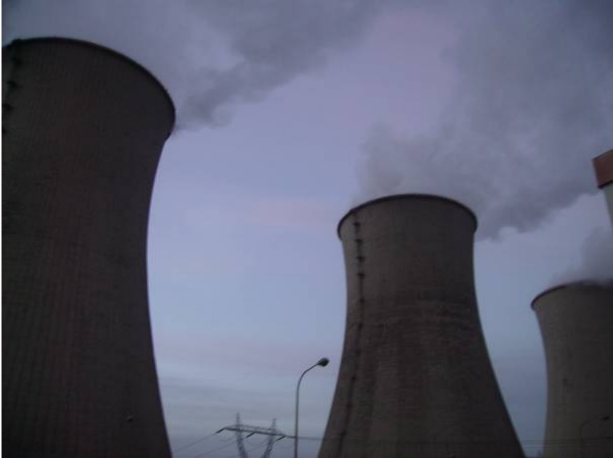
Torres de refrigeración
