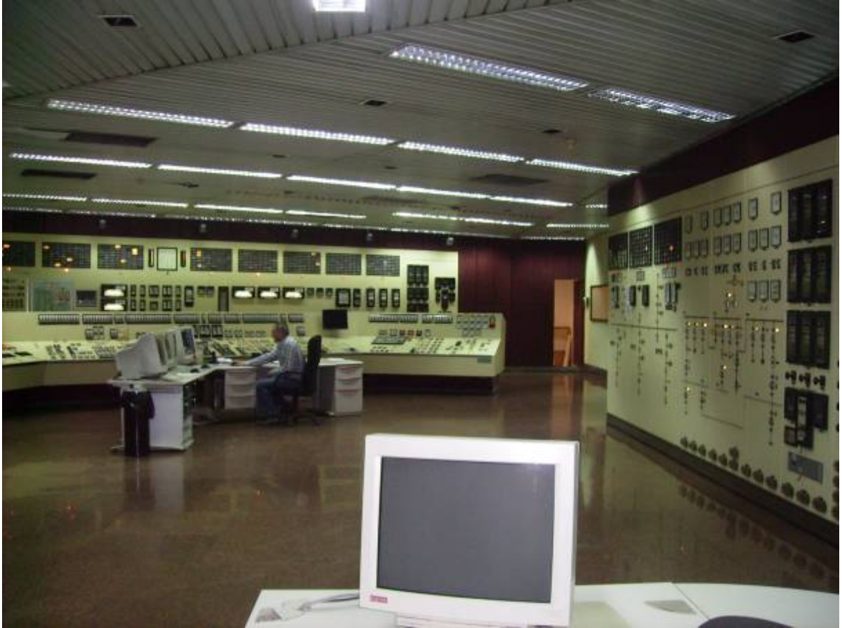
Sala de control de la Central Térmica
